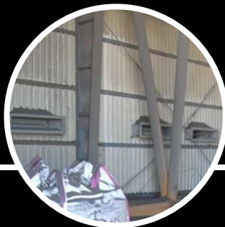
داکتینگ سالن سندبلاست Sandblasting hall ducting
